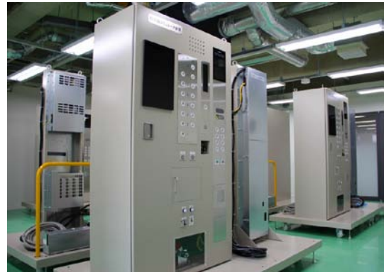
エレベーター制御盤の模擬実習装置
