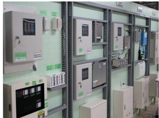
遠隔監視制御システムの実習設備
