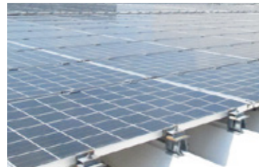
太陽光発電設備
