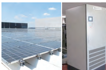
太陽光発電設備
