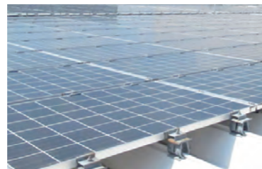
太陽光発電設備
