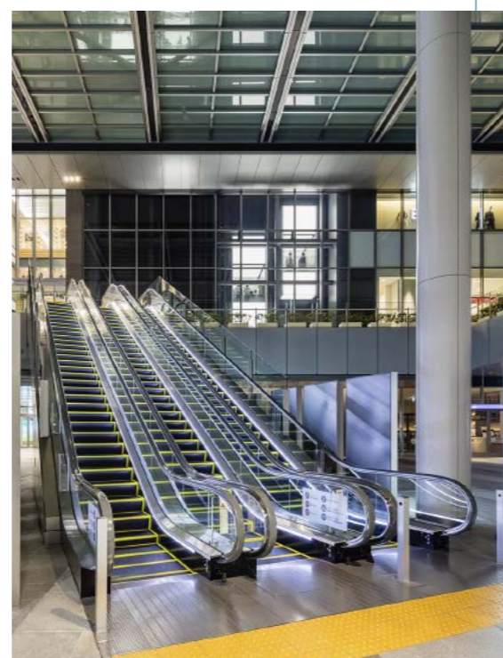
屋外 エスカレーター
