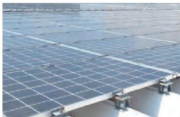
太陽光発電設備
