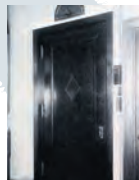
乗用エレベーター第1号機
