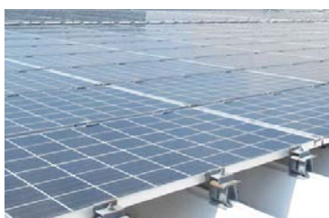
太陽光発電設備
