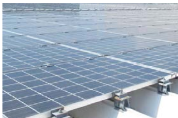
太陽光発電設備
