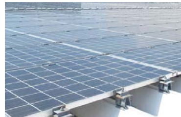
太陽光発電設備
