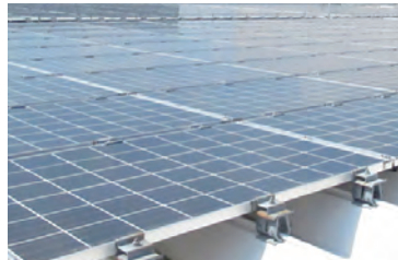
太陽光発電設備
